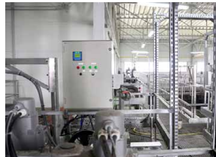
Nowoczesne wnętrze oczyszczalni ścieków RPWiK w Dąbrowie Tarnowskiej
